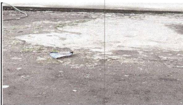
FOTO 10: Sustrucción de piso de torta de concreto
